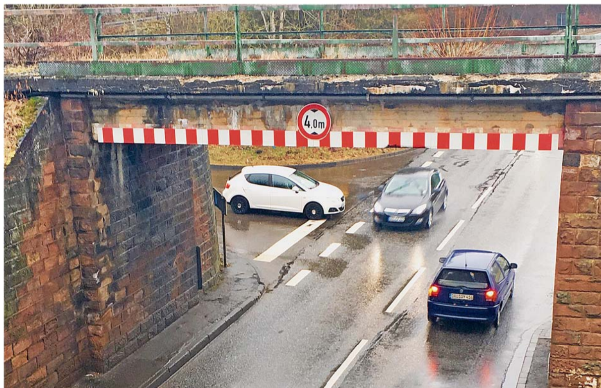
Schlechte Sicht, gefährliche Einmündung: Vor allem wegen der Bahnbrücke, die bis zum Sommer abgerissen werden soll, kommt es an der Einmündung der L24 in die B410 bei Lissingen oft zu brenzligen Situationen. FOTOS (3): MARIO HÜBNER
