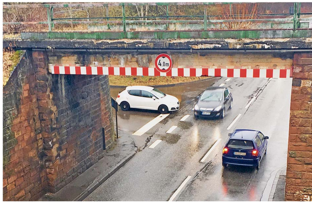
Schlechte Sicht, gefährliche Einmündung: Vor allem wegen der Bahnbrücke, die bis zum Sommer abgerissen werden soll, kommt es an der Einmündung der L24 in die B410 bei Lissingen oft zu brenzligen Situationen. FOTOS (3): MARIO HÜBNER
